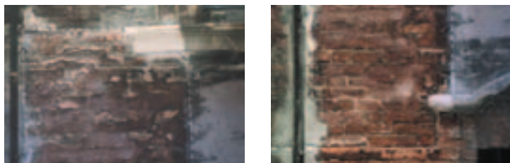
Stato del degrado della facciata su via Roma
