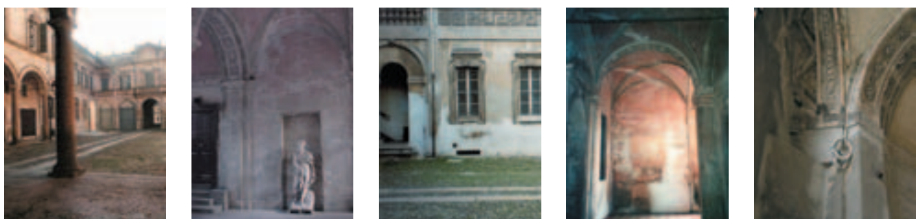
Stato del degrado del cortile interno
